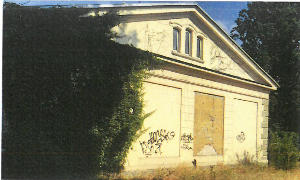
Zdjęcie – graffiti na elewacji wschodniej
